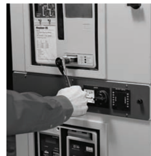
Levering Magnum DS Breaker
